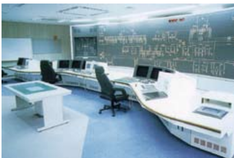
『監視制御システム』では、設計、制作・検査、現地調整までトータルにサポートする
