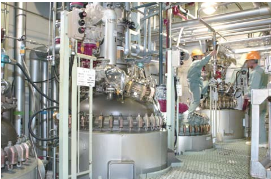
製造工場では各種反応釜が稼働。“安全第一”を掲げ操業している
