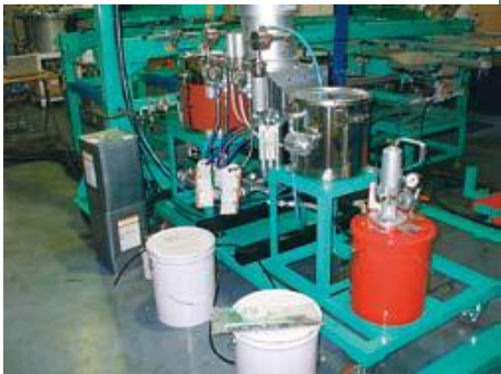
ミルクパック搬送・箱詰装置 (右)、接着剤ポンプユニット (左)
