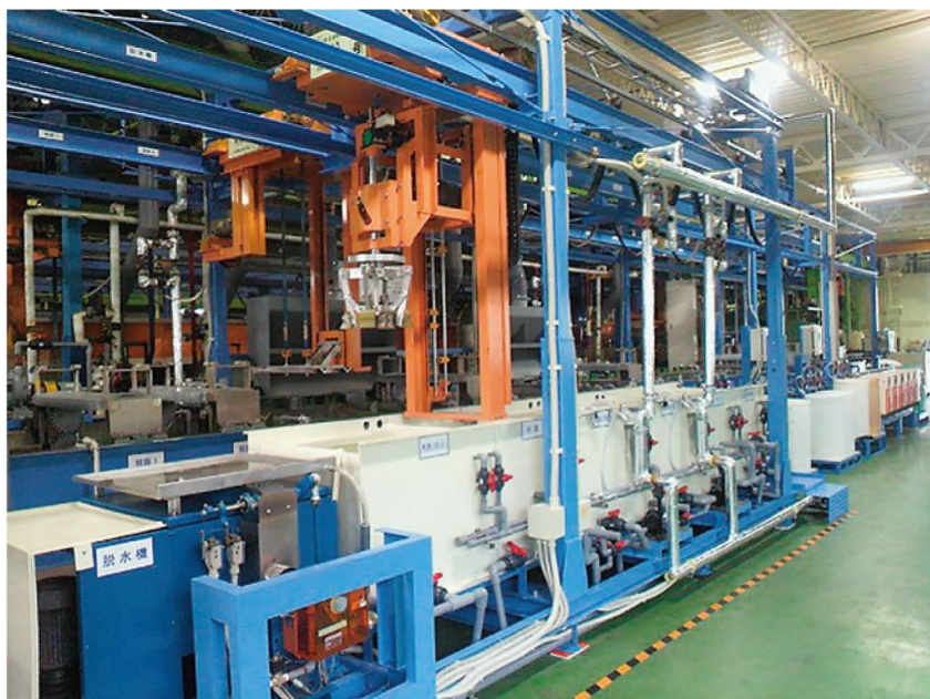
増設したメッキライン装置
