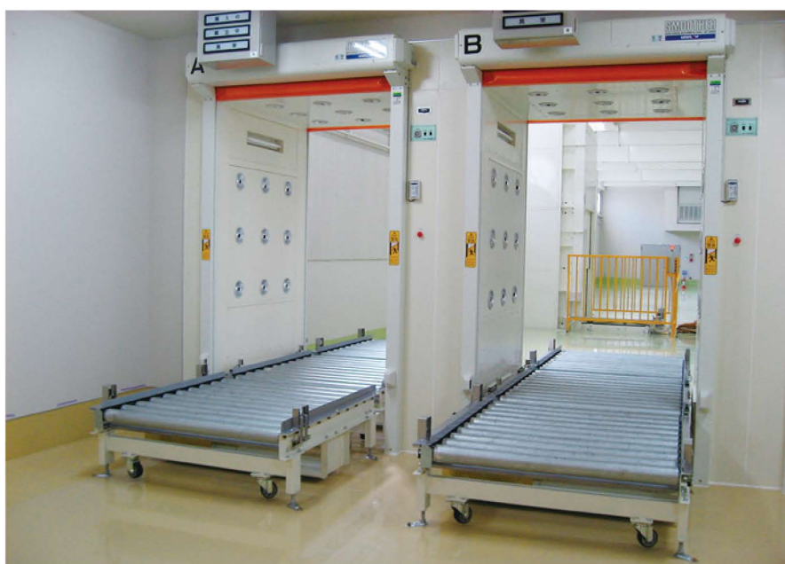
エアシャワー用搬送コンベヤ
