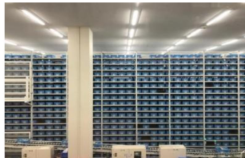
東大阪物流センター ロータリーラック
