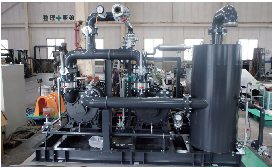
真空ポンプユニット
